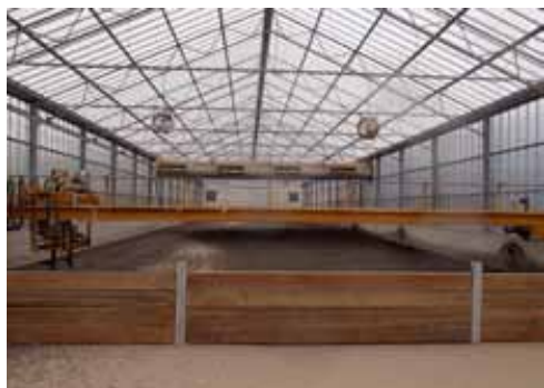
Serre de séchage solaire à l'Étang-Salé, La Réunion (France).
