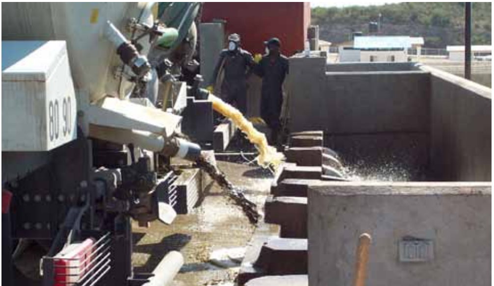
Dépôt des boues vidangées par camion au niveau de la station de traitement de Morne à Cabrit (Port-au-Prince, Haïti).
